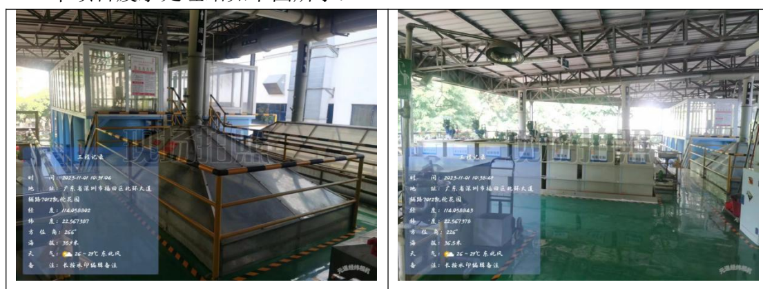
图 3-2 废水站处理现状照片
